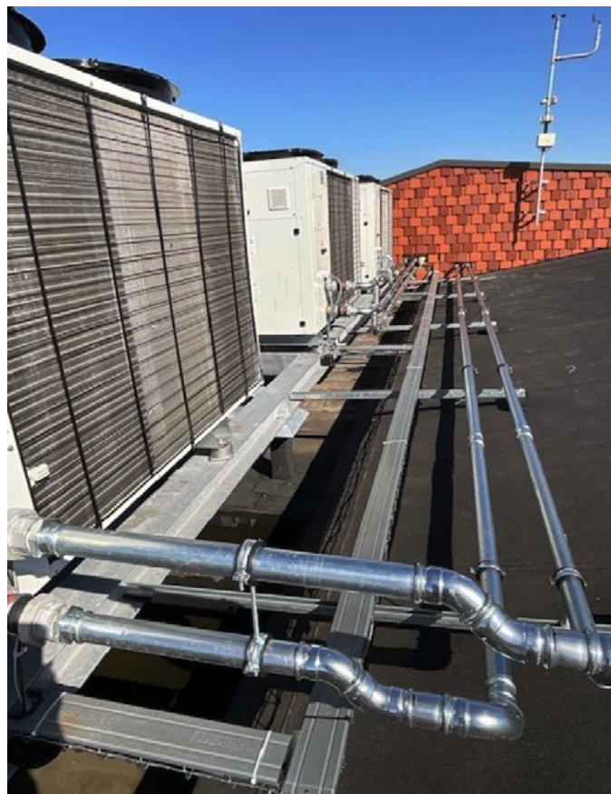
Figuur 1. Collectieve warmtepompen op het dak van een woongebouw
